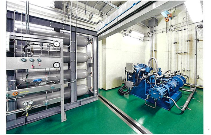
高圧水素ガスコンプレッサ(×2基) 試験に利用した水素ガスを回収して再利用します。 圧力 19.5MPaG 流量 70m³/h
