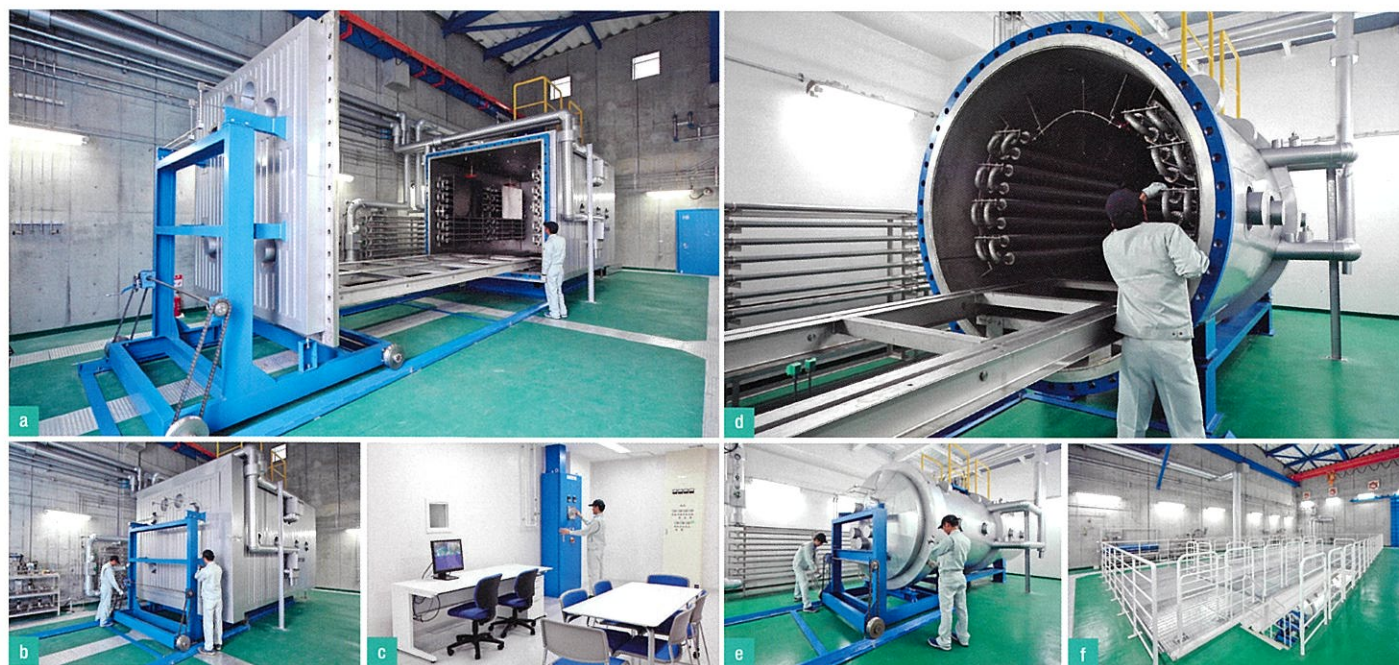
H6・H9 a/大型耐爆カバー 開(直方形) c/制御監視室 b/大型耐爆カバー 閉(直方形)
