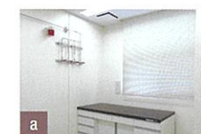
a/ガス供給ライン・吸気口
